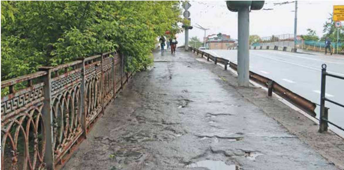
Тротуари в ямах та потребують ремонту
